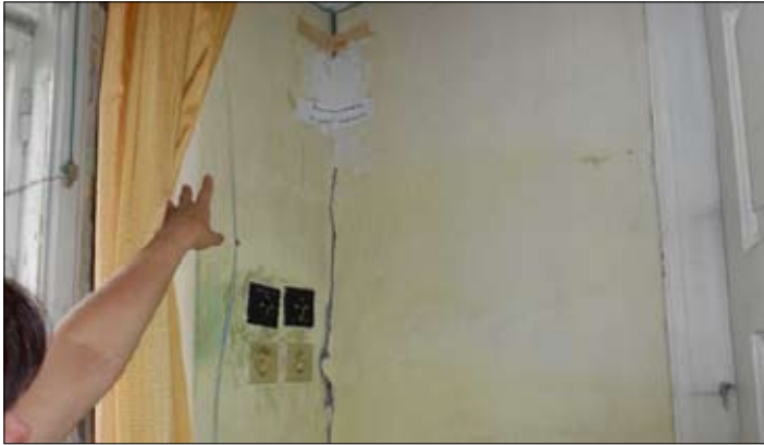
Тріщини на абонементі. 2012 р.
